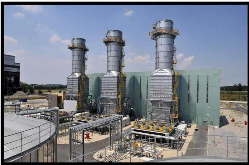
La centrale à 3 turbines à combustion de Vaires-sur Marne dans la région parisienne
